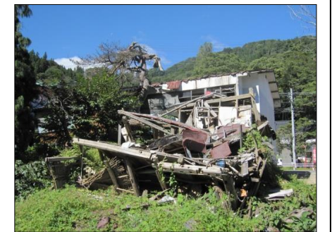
倒壊に至った空き家の事例
