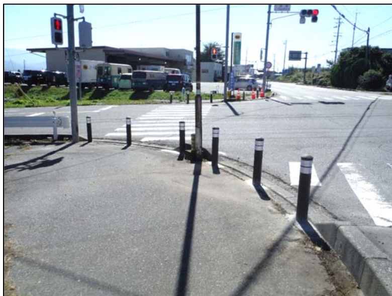
松川インター大鹿線(東浦交差点) 車止めポストの設置(キングポスト)
