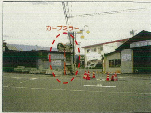
松川インター大鹿線と神護原線交差点 カーブミラー更新
