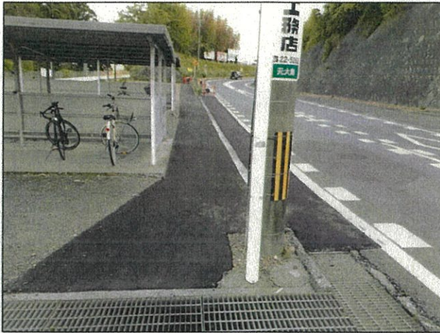
松川インター大鹿線(伊那大島駅付近) R4.5 歩行者通路の設置
