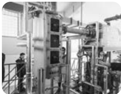
長寿命化工事の完成装置
