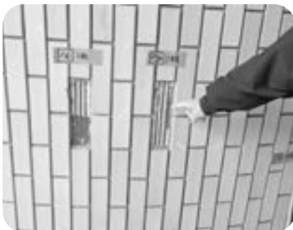
町民体育館の外壁の剥がれ
