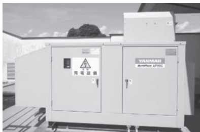
同タイプの喬木荘の発電機
