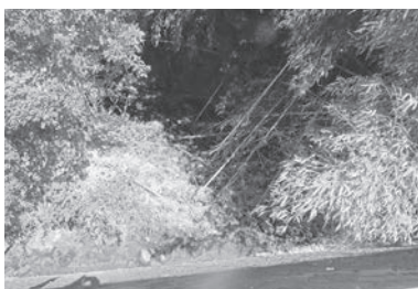
現在の荒れた相の沢排水溝
