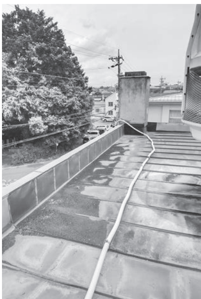
早急に雨漏り対策を
