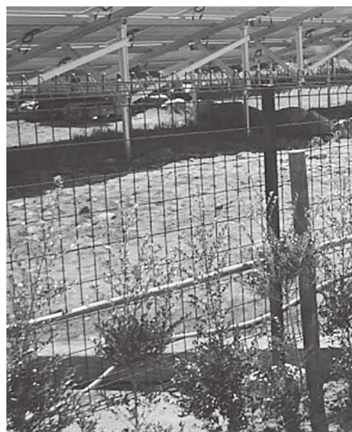
緑化整備された設備
